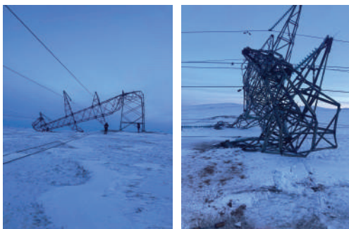
Тулгуур №68 гэмтсэн байдал
